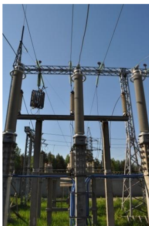
Рис.1 Изоляционные колонны ВОПТН NXVCT -230 фазы А,В,С
